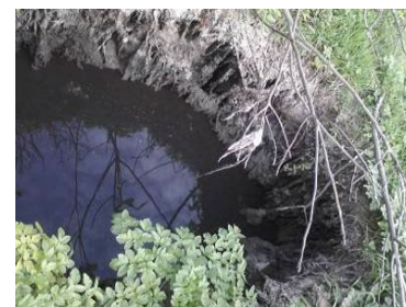
Zonas onde o coletor existente colapsou.
