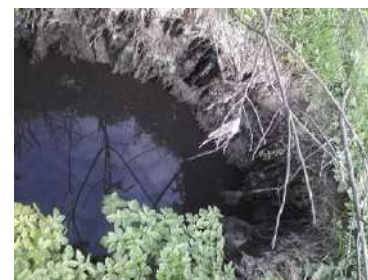
Zonas onde o coletor existente colapsou.
