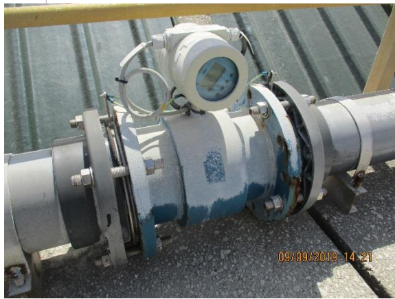
Vista de equipamento com corrosão.
