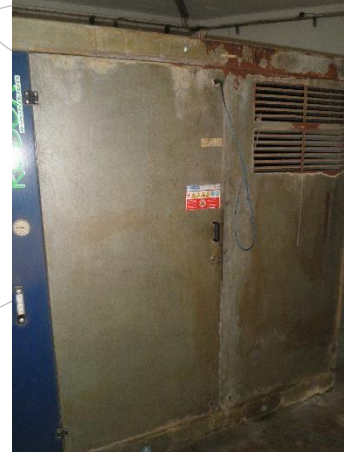
Evidencia de corrosão/oxidação na estrutura do equipamento
