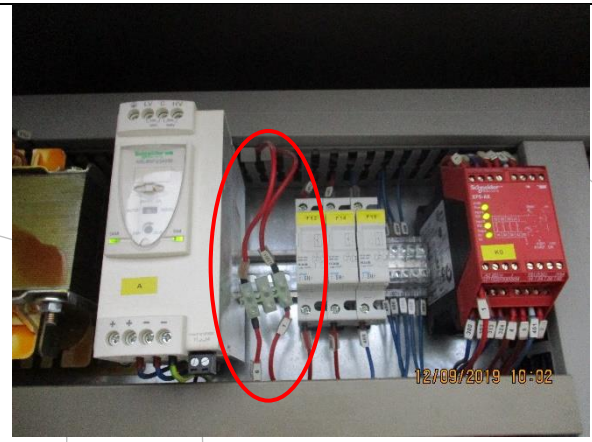
Ausência de proteção diferencial no quadro SB1
