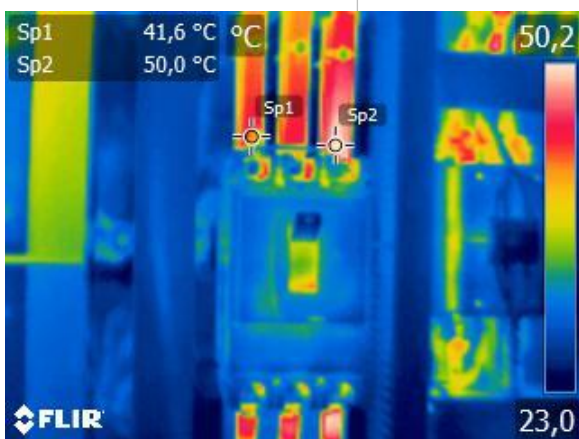
Termograma: Temperatura ligeiramente superior na fase 3. Recomenda-se a limpeza dos contactos e o reaperto das ligações.
