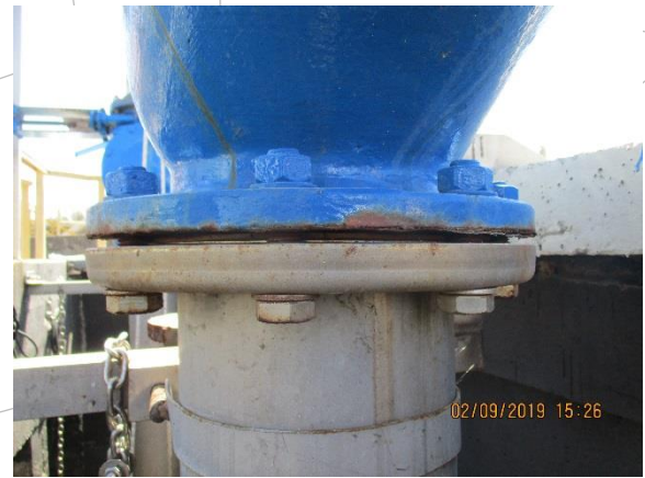
Evidência de corrosão entre metais dissimilares.
