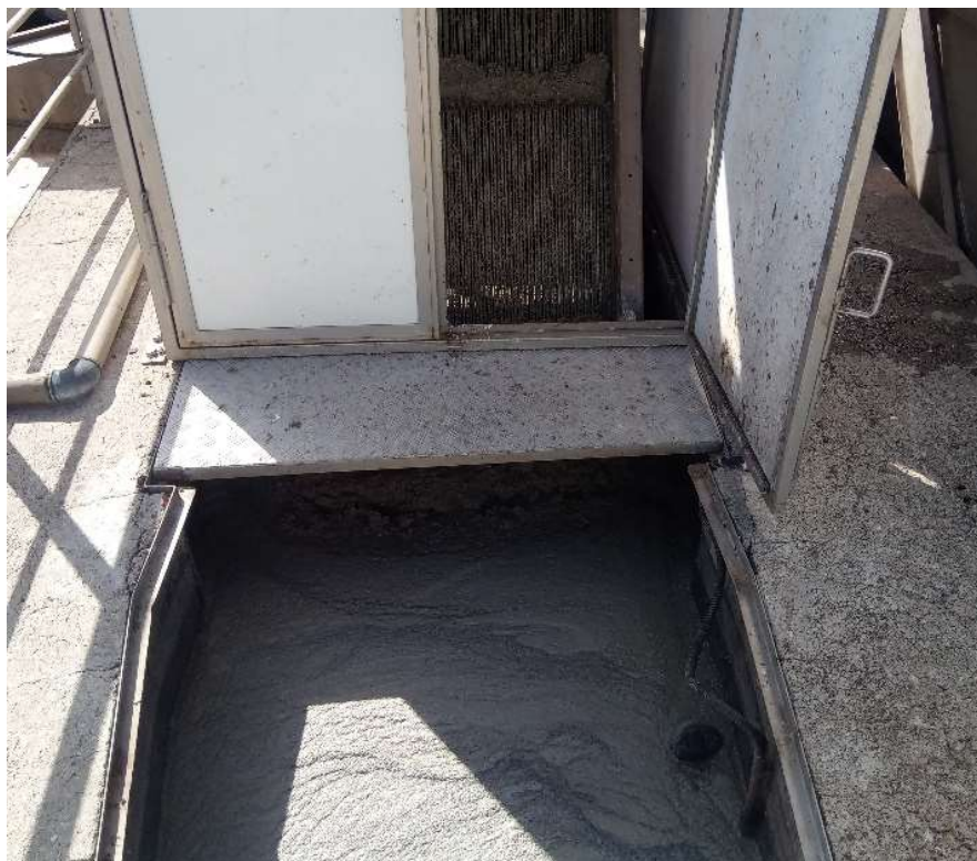
FIGURA 4 – Afluente com elevada presença de gorduras na obra de entrada 23/09/2019 (segunda feira)
