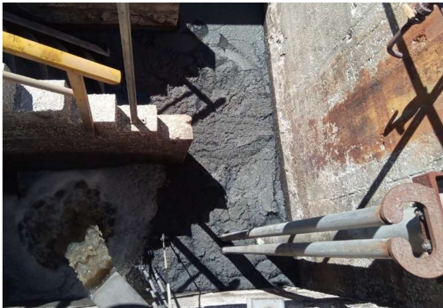
FIGURA 3 – Afluente com elevada presença de sólidos na obra de entrada
