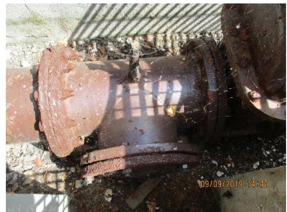
Vista de acessórios e elementos de ligação com corrosão.
