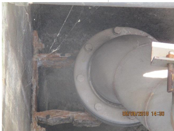
Vista de corrosão em fixações de tubagem.
