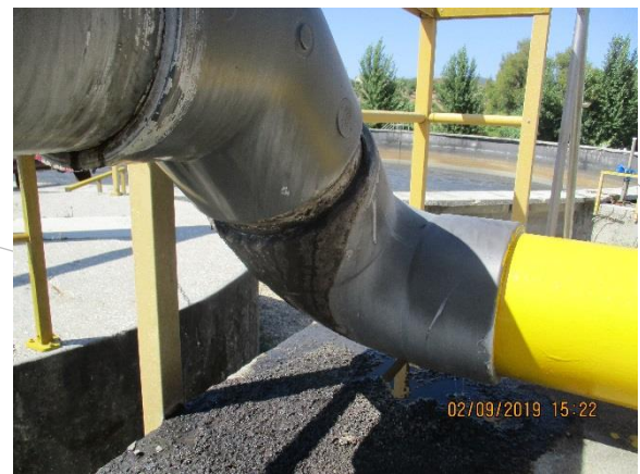
Pormenor de fuga em acessório.
