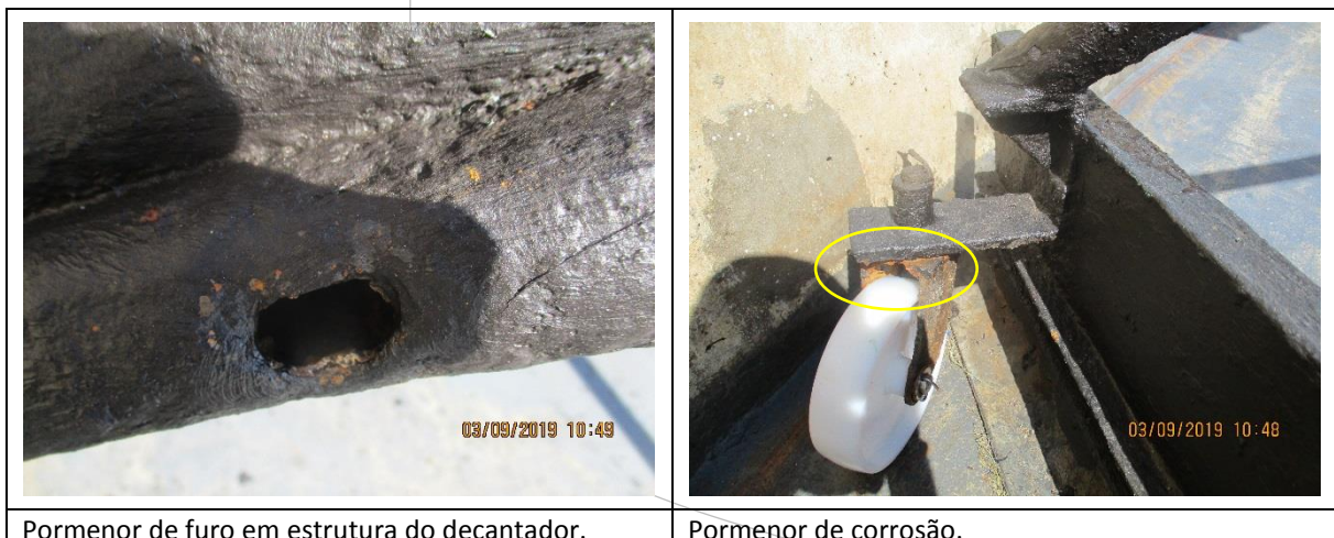
Pormenor de furo em estrutura do decantador.
