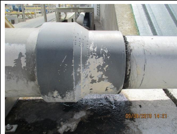
Pormenor de fuga em acessório.
