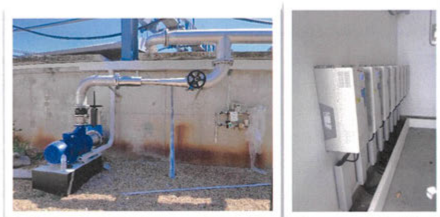
Sistema de Injeção de Oxigénio Líquido
