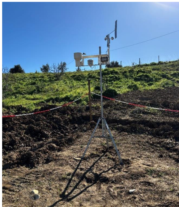
Figura 5.1. Estação meteorológica instalada na ETAR de Alcanena.
