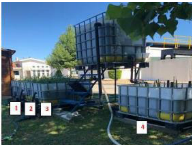
Figura 2.17. Instalação piloto de unidades de macrófitas na ETAR de Alcanena.
