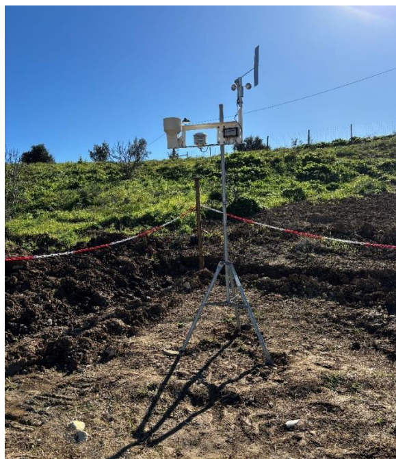
Figura 5.1. Estação meteorológica instalada na ETAR de Alcanena.
